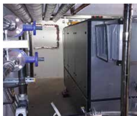
Ein Blockheizkraftwerk für Nahwärme kommt in der neuen Energiezentrale zum Einsatz.
