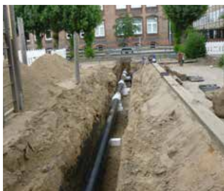
Die versorgten Objekte sind über in der Erde verlegte Leitungen verbunden.
